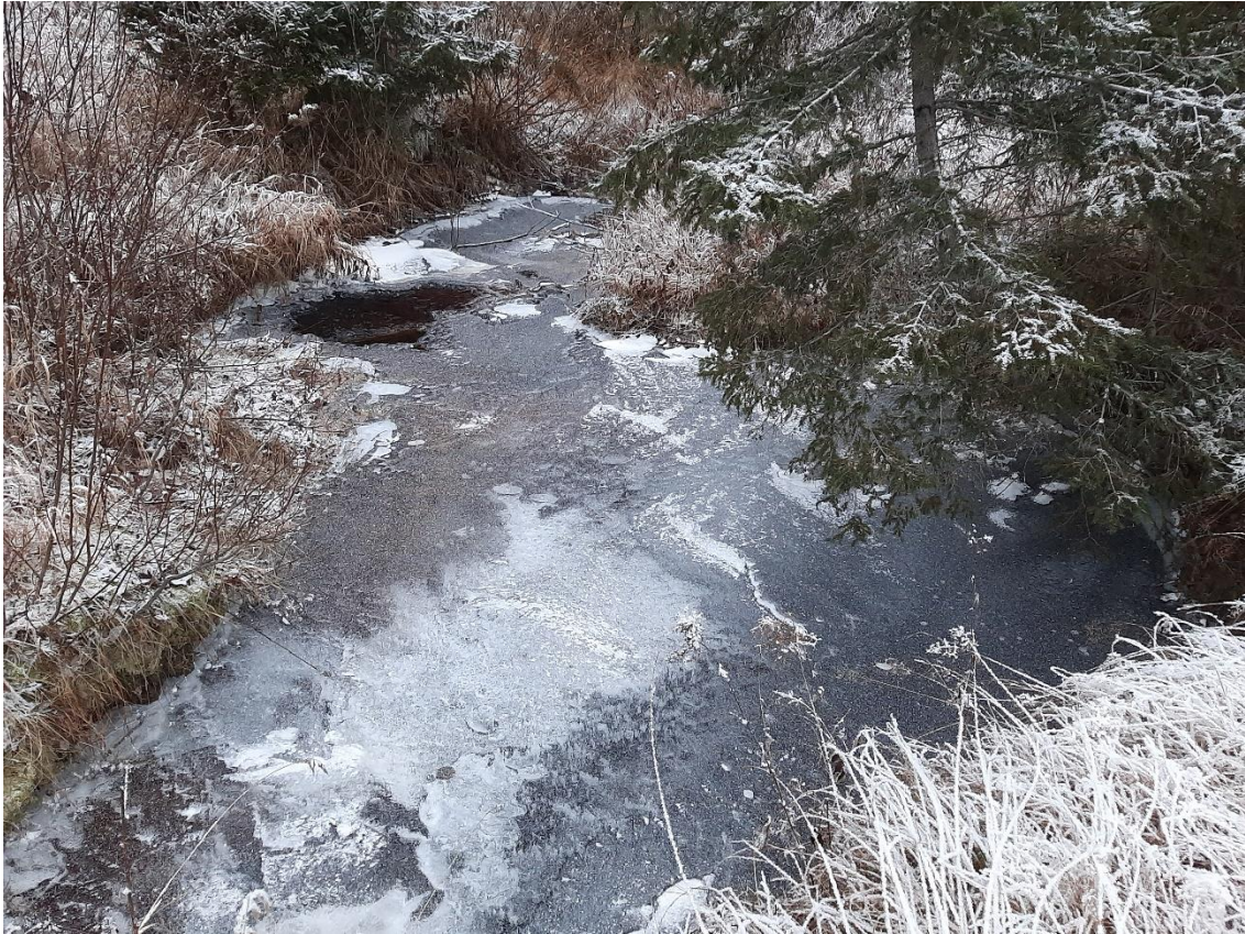
KUVA 10 Keskisen pellon eteläpuolella on syöpymää. Rakennetaan pieni pohjapato ja uoman kiviverhoilu kalliolouhoksesta tai seulanpääkivistä.
